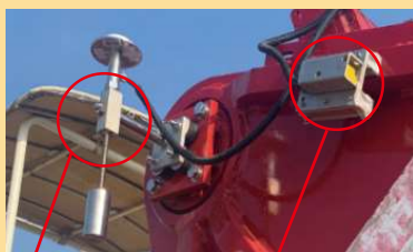
GNSS アンテナ
